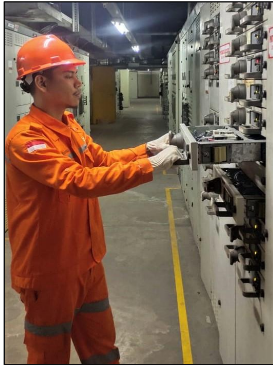
Gambar 4.5 CB 3 Phasa 380 V dikeluarkan dari Switch Gear
