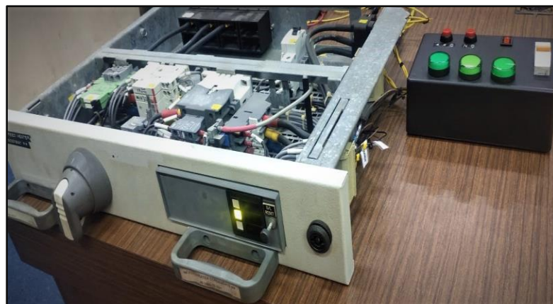
Gambar 4.10 Pengujian Indikasi OFF pada CB 3 Phasa 380 V
