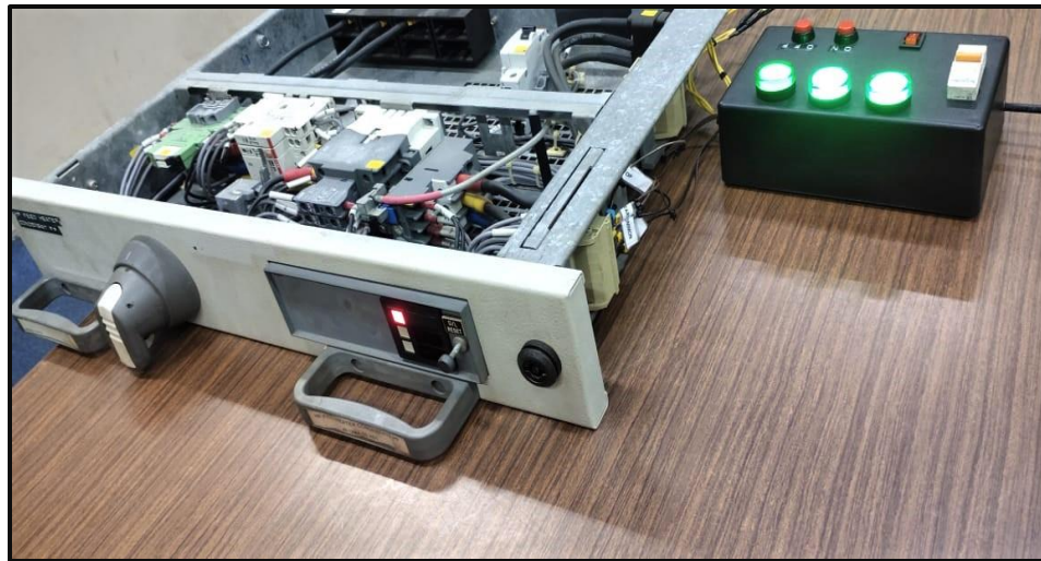
Gambar 4.8 Pengujian Indikasi ON pada CB 3 Phasa 380 V
