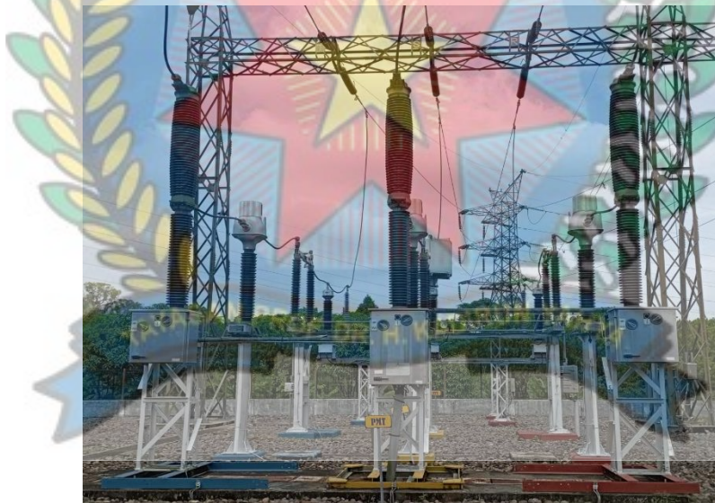
Gambar 2.22 Circuit Breaker SF 6 Gardu Induk P.Brandan
