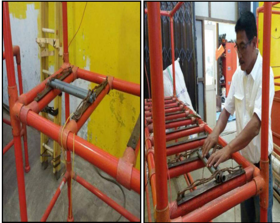
Gambar 3.11 Pengujian Tabung Urgent Cut Out Sumber : PLN UPDL Semarang, 2017
