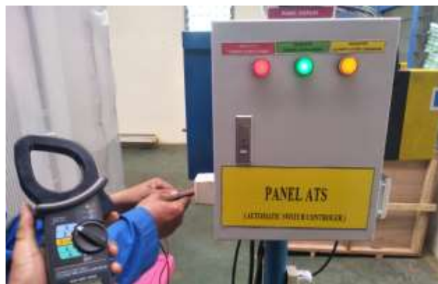
Gambar 4.1 Pengujian output inverter Sumber:
