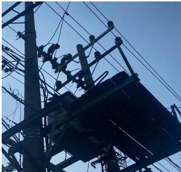
Gambar 3.22 Tabung Urgent Cut Out Pada Gardu Distribusi BR 390 Sumber: ULP Medan Baru, 2021
