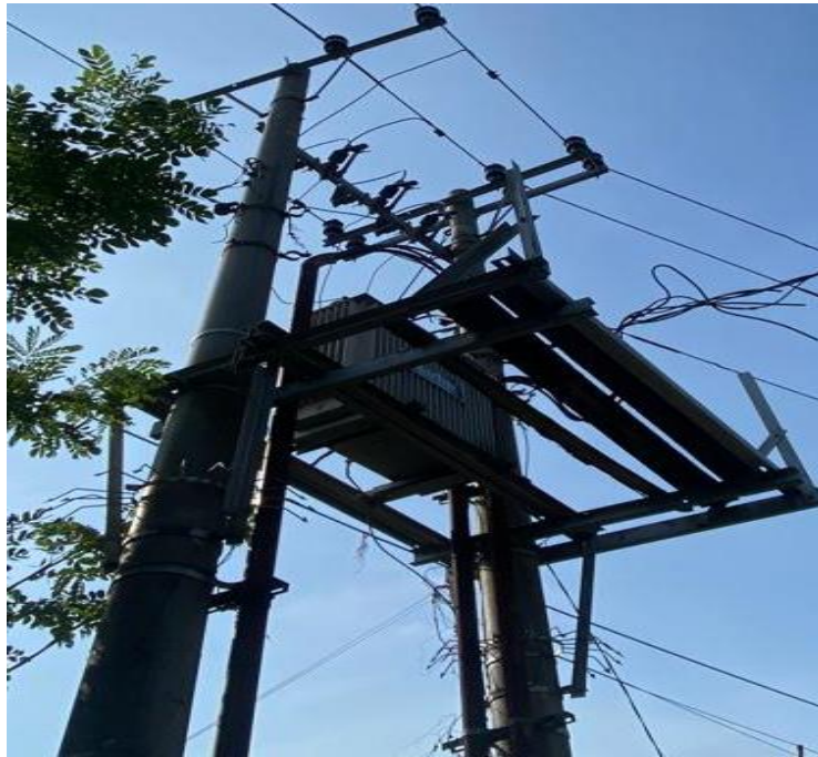
Gambar 3.21 Tabung Urgent Cut Out Pada Gardu Distribusi BR 202 Sumber: ULP Medan Baru, 2021
