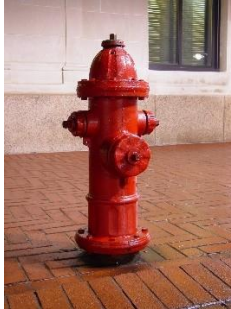
Gambar 4.37 Fire Hydrant Sumber: penulis,2021
