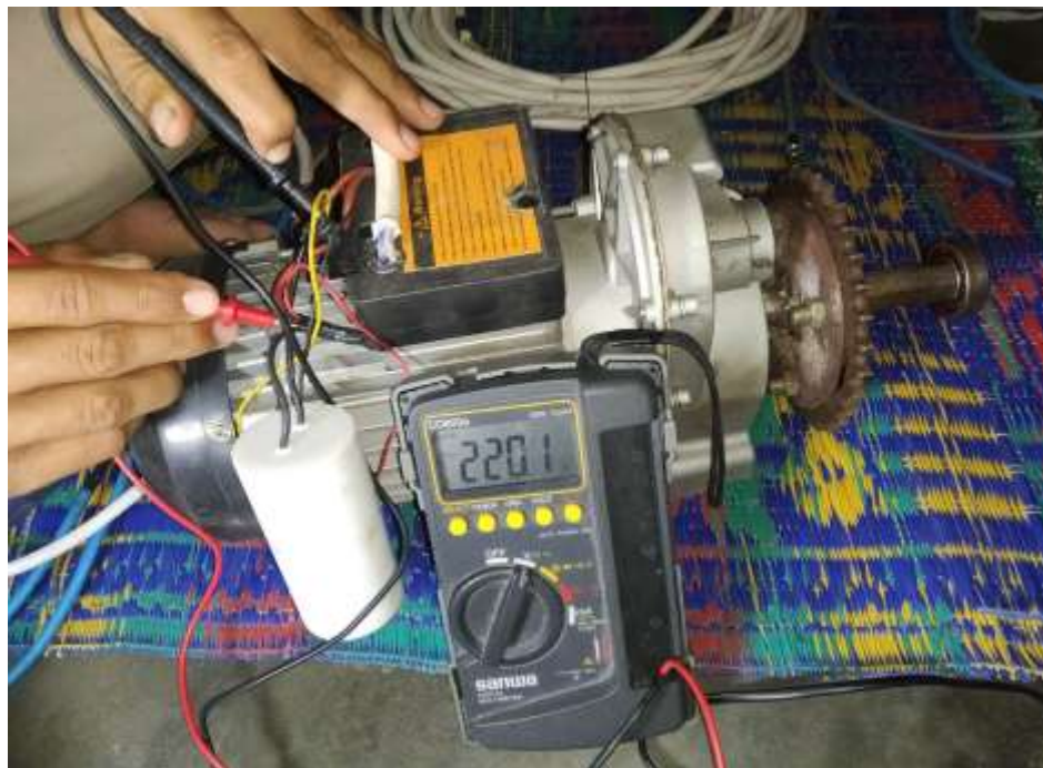
Gambar 4. 10 Pengukuran Tegangan Pada Motor AC
