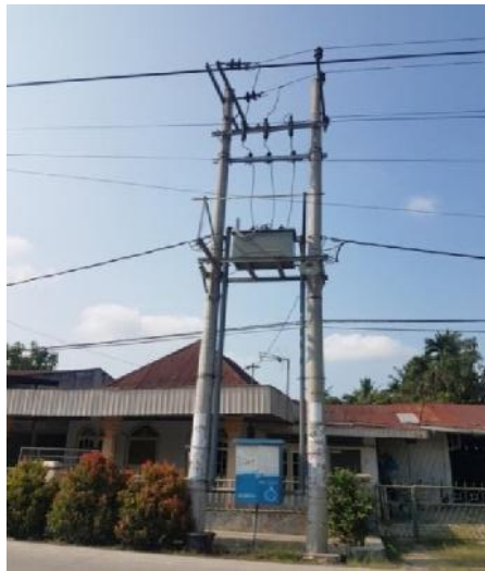
Gambar 2.6 Gardu Distribusi Portal Sumber: Penulis, 2021
