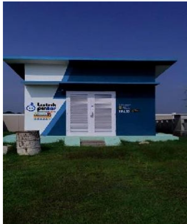
Gambar 2.3 Gardu Distribusi Beton Sumber: Penulis, 2021
