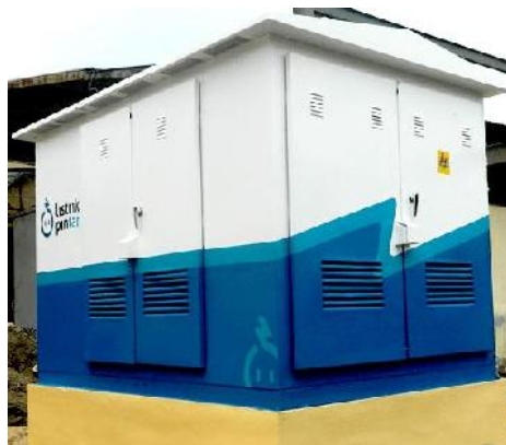
Gambar 2.5 Gardu Distribusi Kios Sumber: Penulis, 2021
