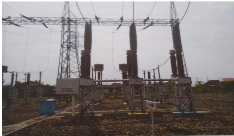
Gambar 2.22. Pemutus Tenaga (PMT) Circuit Breaker (CB)
