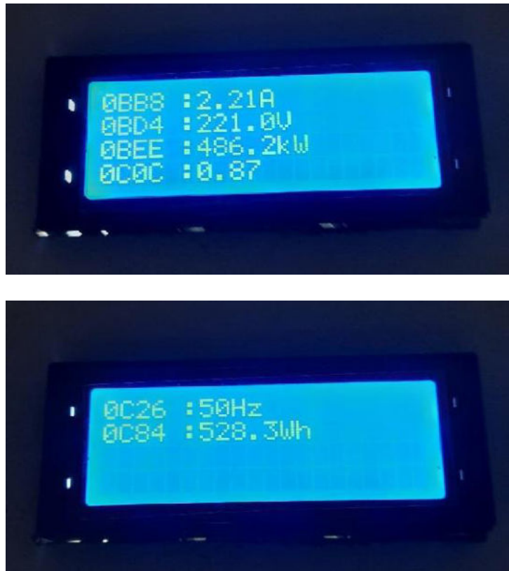
Gambar 4. 4 Pengujian Energi Meter
