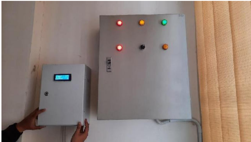
Gambar 4. 1 Keseluruhan Alat (Panel kontrol SiSCE)
